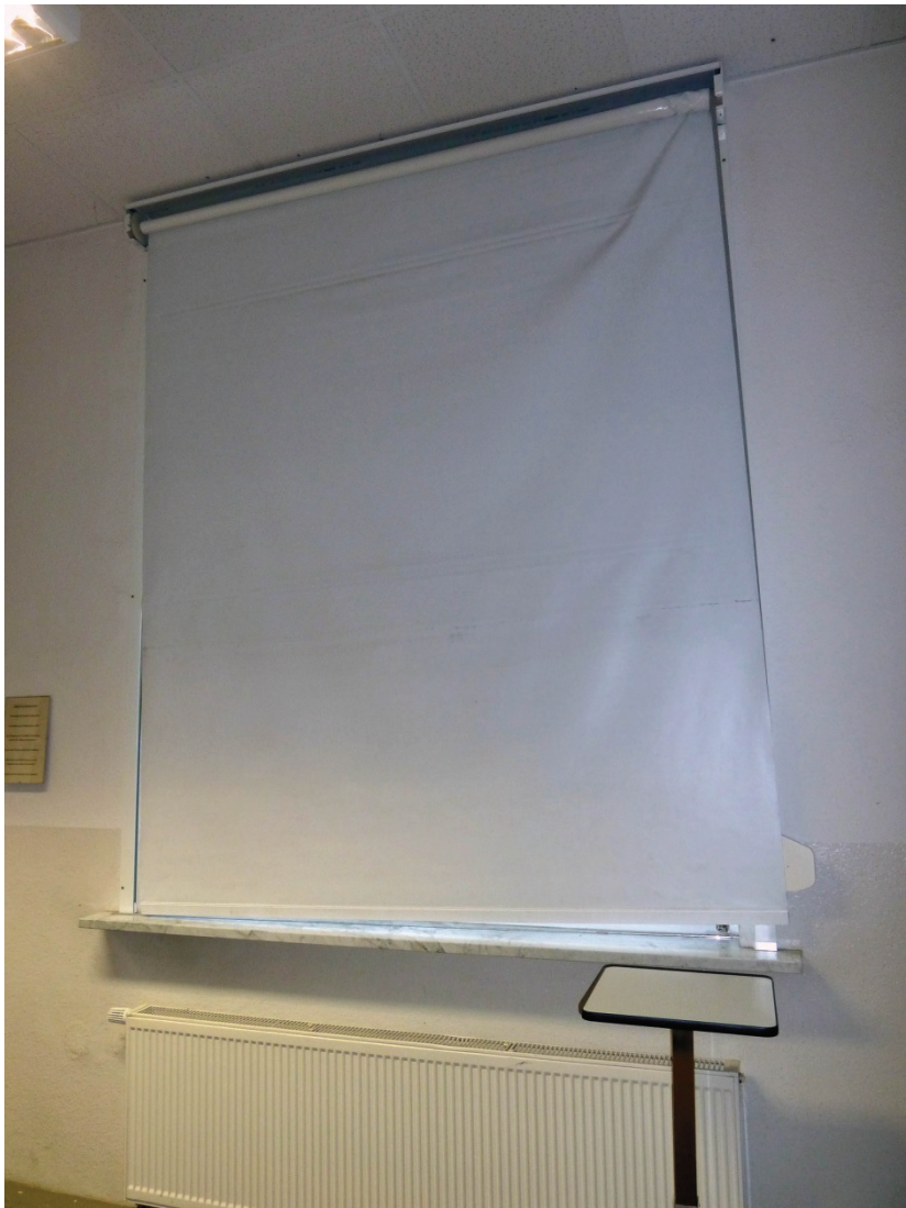
PC-Raum - defektes Verdunklungsrollo – es hängt runter und kann nicht mehr aufgerollt werden
